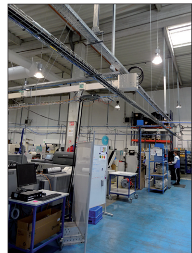
Stockage de produits chimiques et circuits aériens d'alimentation vers les zones de production
