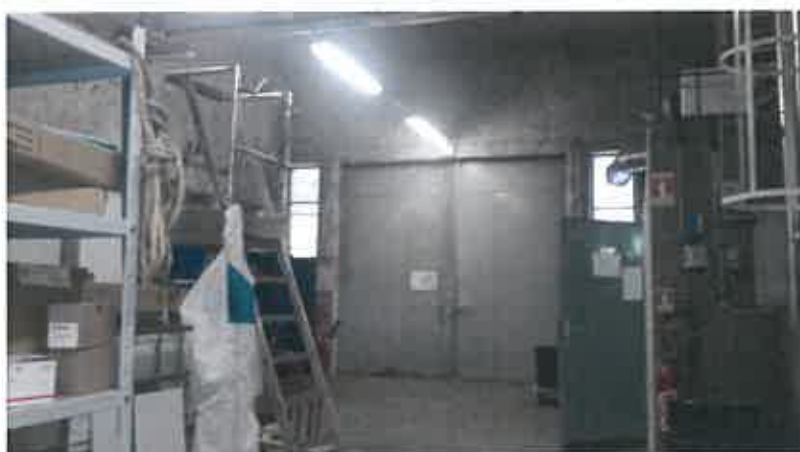
Ventilation haute de la chaufferie bois
